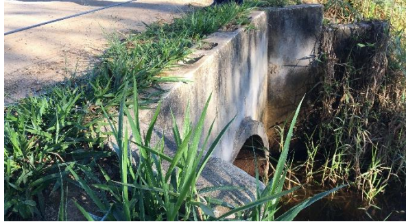
FIGURA 15 – TRAVESSIA LOCALIZADA NA ESTRADA DA ÁGUA BRANCA FONTE: PLANO DE MACRODRENAGEM DE POTIM, 2019
