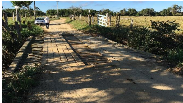
FIGURA 18 – TRAVESSIA LOCALIZADA PRÓXIMO AO ENTRONCAMENTO COM A ESTRADA DA ÁGUA BRANCA FONTE: PLANO DE MACRODRENAGEM DE POTIM, 2019
