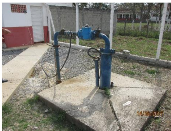
FIGURA 48 – CAPTAÇÃO SUPERFICIAL - CIDADE NOVA FONTE: ACERVO DO AUTOR, 2017
