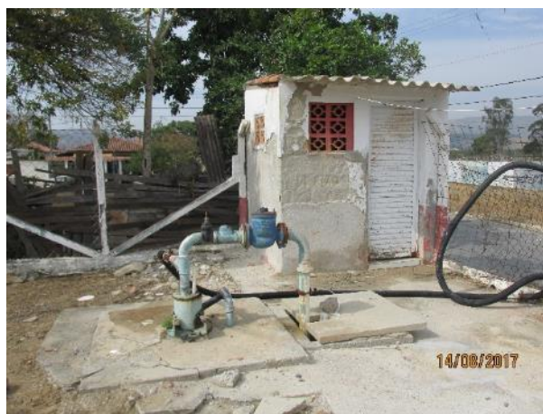
FIGURA 45 - CAPTAÇÃO SUPERFICIAL – BARRANCO ALTO FONTE: ACERVO DO AUTOR, 2017
