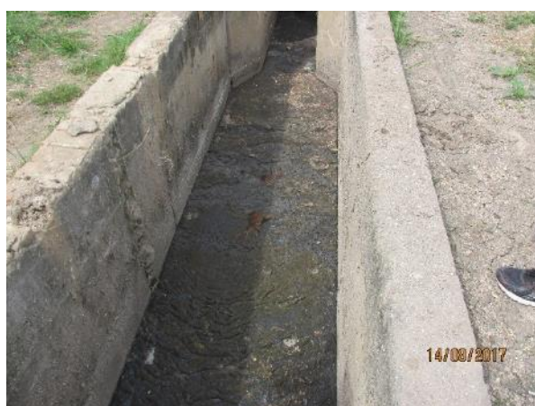
FIGURA 66 – ETE MIGUEL VIEIRA – VISTA 2 (FONTE: ACERVO DO AUTOR, 2017)
