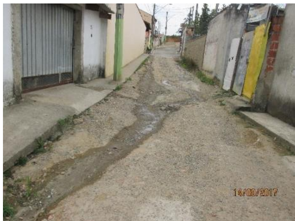
FIGURA 76 - DRENAGEM SUPERFICIAL NO BAIRRO MIGUEL VIEIRA FONTE: ACERVO PESSOAL, 2017
