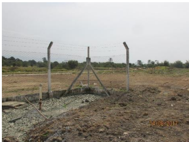
FIGURA 46 – CAPTAÇÃO SUPERFICIAL - CDHU FONTE: ACERVO DO AUTOR, 2017
