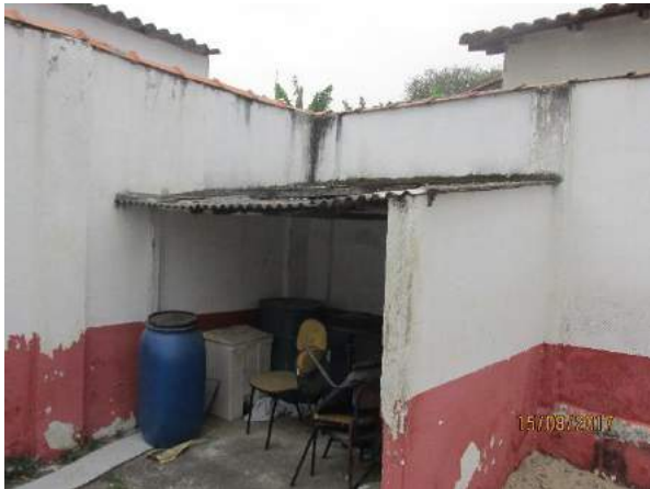
FIGURA 71 – ARMAZENAMENTO IRREGULAR DE RSS NO PSF-A (FONTE: ACERVO DO AUTOR, 2017)
