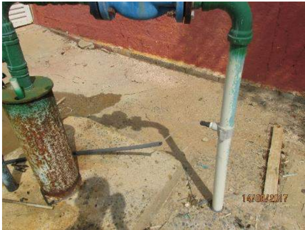
FIGURA 45 – MANANCIAL SUBTERRÂNEO MIGUEL VIEIRA – VISTA 1
