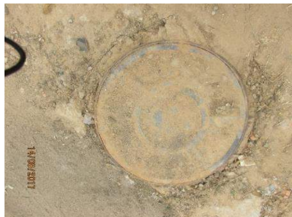
FIGURA 51 - POÇO DE VISITA – VISTA 2 (FONTE: ACERVO DO AUTOR, 2017)
