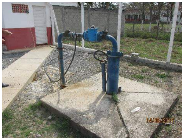
FIGURA 37 – CAPTAÇÃO SUPERFICIAL - CIDADE NOVA (FONTE: ACERVO DO AUTOR, 2017)
