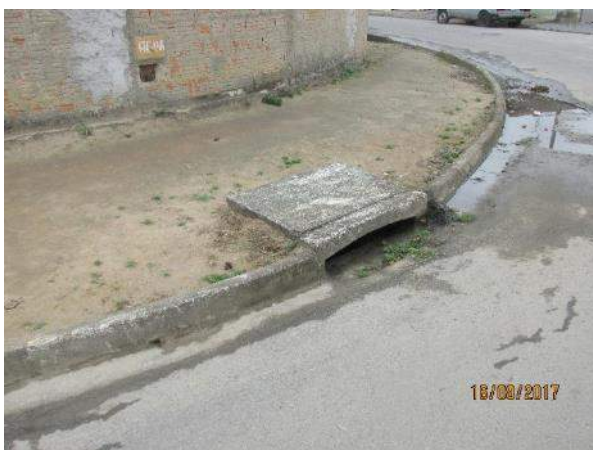
FIGURA 88 - BOCA DE LOBO NO BAIRRO DO CDHU (FONTE: ACERVO PESSOAL, 2017)
