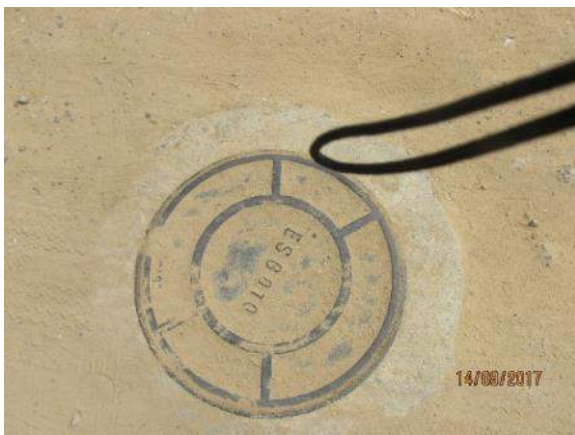
FIGURA 50 - POÇO DE VISITA – VISTA 1 (FONTE: ACERVO DO AUTOR, 2017)
