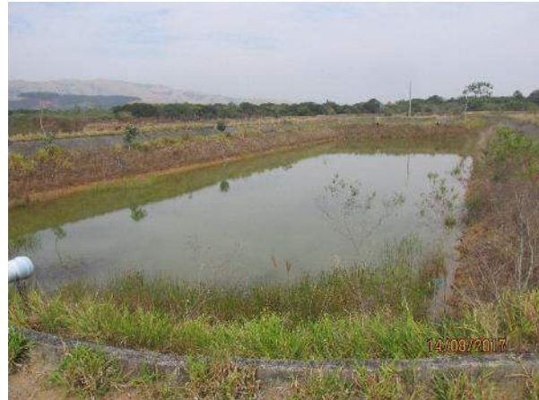
FIGURA 53 – ETE PRINCIPAL – VISTA 2 (FONTE: ACERVO DO AUTOR, 2017)
